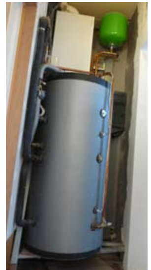
Chaudière et ballon d'eau chaude sanitaire.
