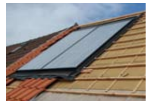
Panneaux solaires thermiques.
