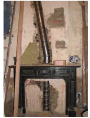
Tuyaux de ventilation dans les cheminées.
